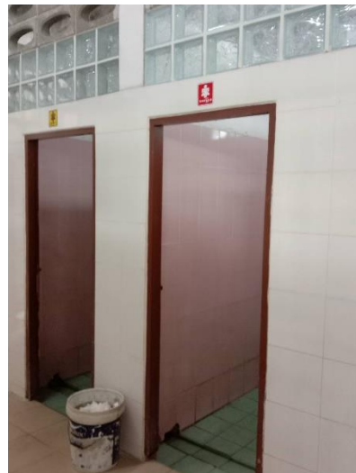
มีห้องส้วมแยก เพศชาย-หญิง
