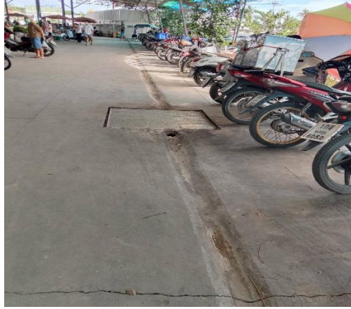
มีรางระบายน้ำเสีย
